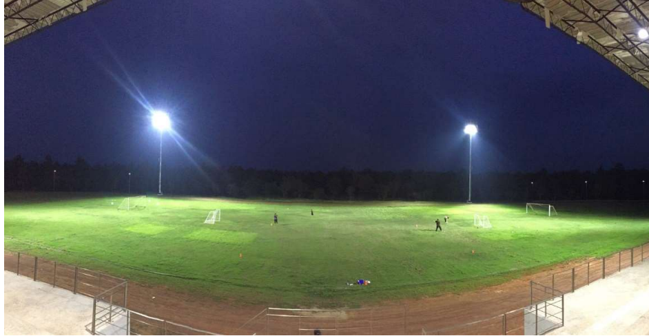
รูปที่ 17 ภาพ ระบบไฟฟ้าแสงสว่าง บริเวณสนามฟุตบอล มจร.ราชบุรี
